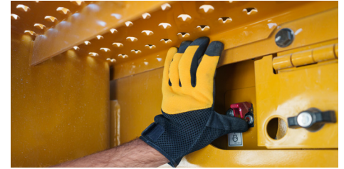
APAGADO A NIVEL DEL SUELO
