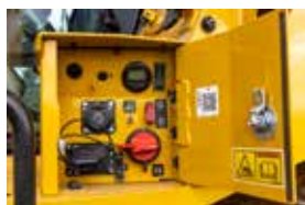
地面高度維修中心
