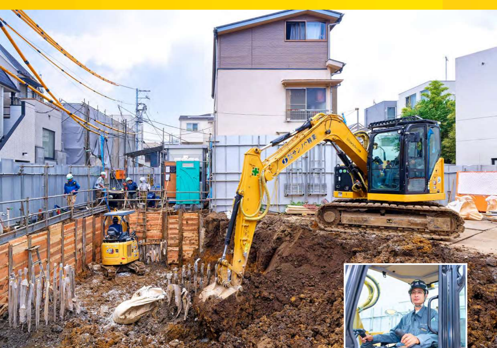
住宅地のマンション工事現場で作業を行う308 CRと301.7 CR。
