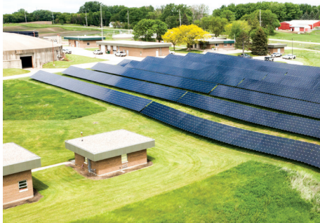
El sistema solar funciona con el calor y la humedad del soleado clima del medio oeste superior.
