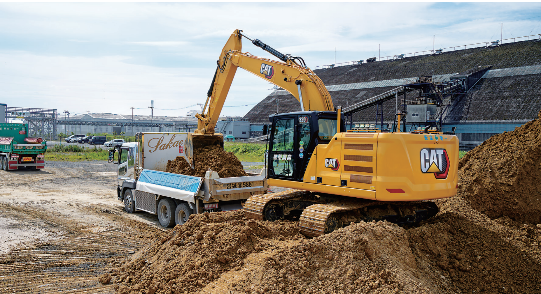
築堤用の土砂運搬をパワフルにサポートする次世代320。効率的なトラック積込にペイロード機能が威力を発揮。
