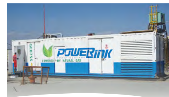
▲ 坐落在油田中的PowerLink燃气发电机组，搭载Perkins动力。油田位于海边，操作环境恶劣。
