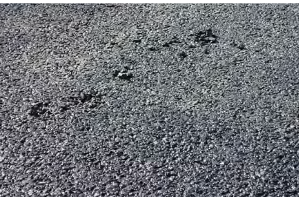
Pedaços arrancados da mistura fresca devido ao asfalto grudado no rolo.
