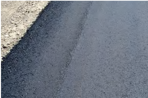
Rachadura da camada de pavimentação ao longo da borda do rolo afastada da borda não confinada.
