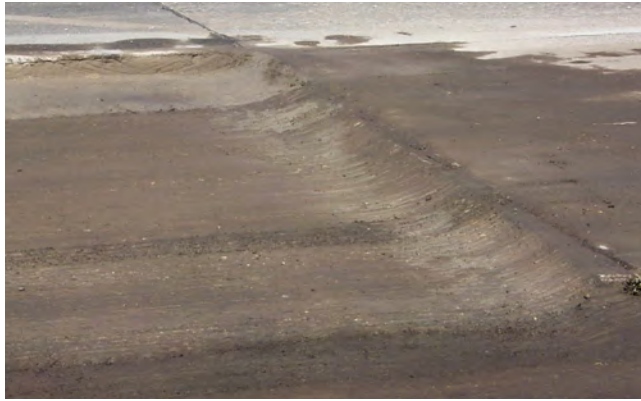
Exemplo de uma referência de início inadequado. Superfície arredondada com um corte profundo com uma compactação obstruída.
