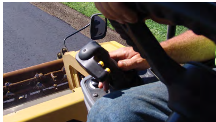
Os bicos de aspersão de água operam apropriadamente quando as orientações da manutenção são seguidas e é usada água limpa.
