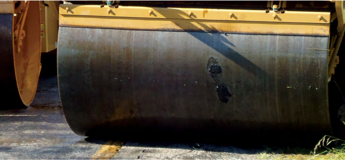
Stone Matrix Asphalt com cimento asfáltico modificado por polímero grudado no rolo de aço.
