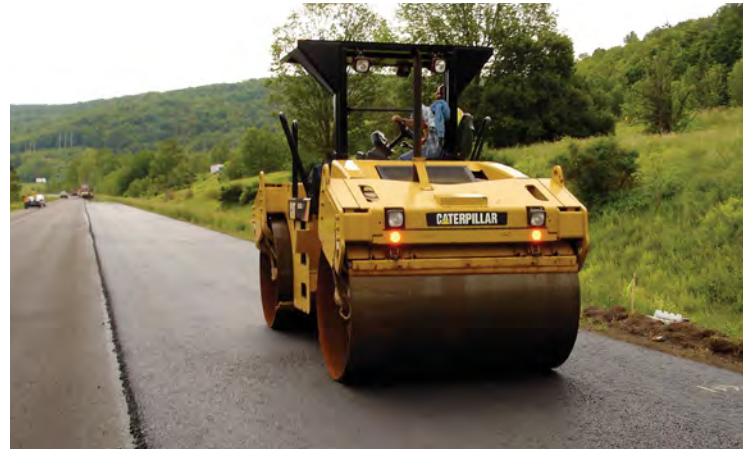
Os compactadores vibratórios usados na fase intermediária são ajustados com amplitude baixa.
