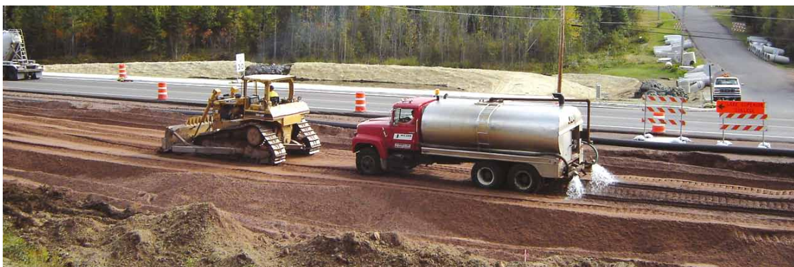
Cuando el contenido de humedad está por debajo del nivel óptimo, se podrá agregar agua para alcanzar una compactación adecuada.
