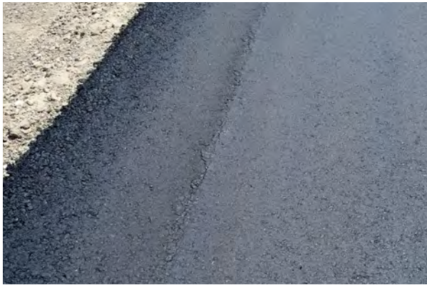
Трещина вдоль линии прохождения края вальца с отступом от края без бокового упора
