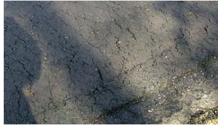
Разрушение свежего асфальта из-за растягивания слоя внешним краем вальца.
