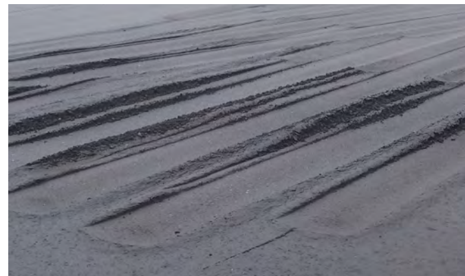
Глубокие следы от шин, появившиеся в результате работы на толстом слое размягченной смеси, плохо поддаются устранению.
