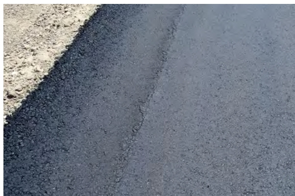
Fissures dans le revêtement le long de la bordure du cylindre et en retrait du bord libre.
