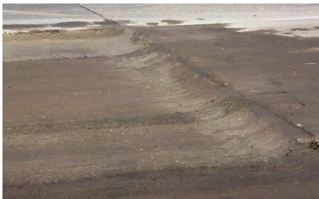
Exemple d'une mauvaise pratique de départ. Une face arrondie avec des entailles profondes entravera le compactage.
