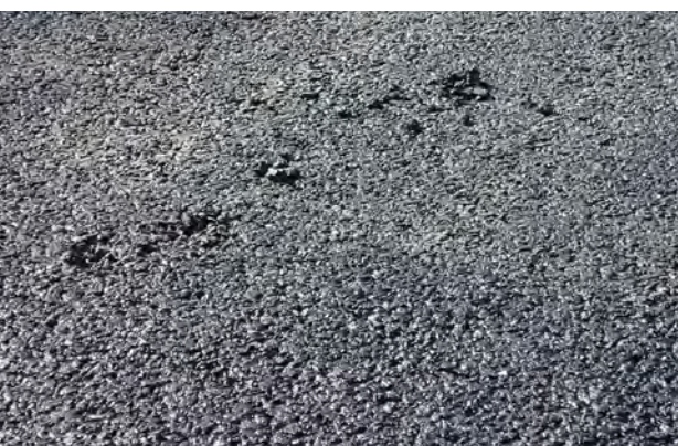
Motte d'enrobé frais arrachée par de l'enrobé collé sur le cylindre.
