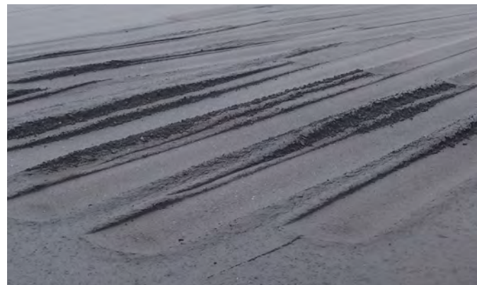
Les marques de pneus profondes, créées dans une couche épaisse composée d'un enrobé tendre, seront difficiles à éliminer.
