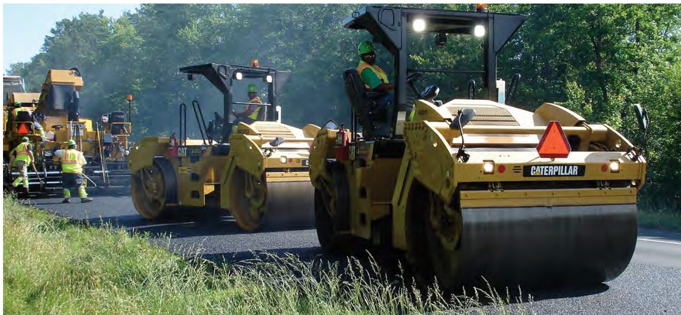
Deux compacteurs de phase initiale changeant de direction derrière un finisseur. Notez l'arrêt en biais.
