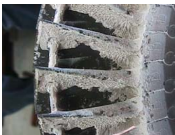
Figura 7: Acumulación de siloxano en la rueda de la turbina del turbocompresor
