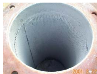
Figura 8: Interior de un silenciador con residuo de siloxano
