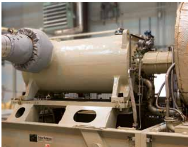
Compresor de gas C61
