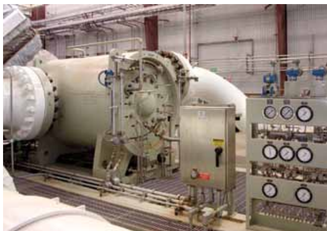
Compresor de gas C65
