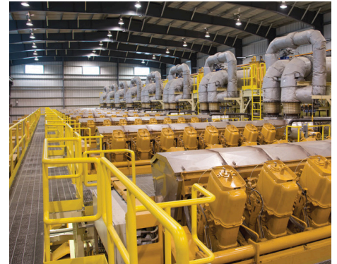
ANC puso en marcha una central eléctrica de 65 MW alimentada con gas natural y por 10 grupos electrógenos Cat® G16CM34.
