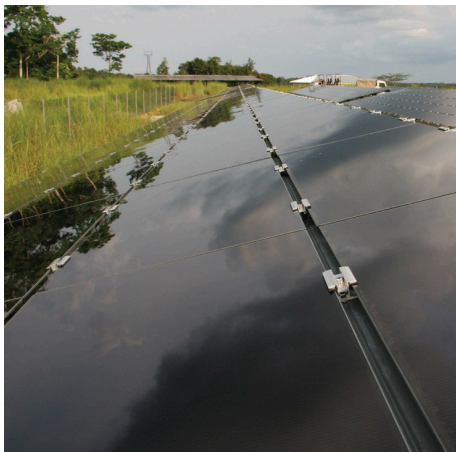
El distribuidor Cat® local, Tractafric Equipment, diseñó e instaló una planta de energía solar compuesta por 420 paneles solares PVT110 Cat.
