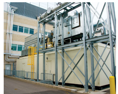
La planta CHP produce más de 16 millones de kWh de energía y alrededor de 50 mil millones de BTU de calor al año.
