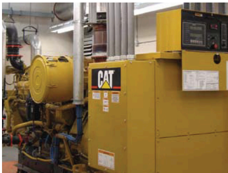
Uno de los dos Cat® 3512B de 1500 kW en espera generadores.
