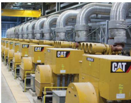
La estación del canal de la calle 17 cuenta con el apoyo de Grupos electrógenos diésel, aparataje y interruptores de transferencia automática.
