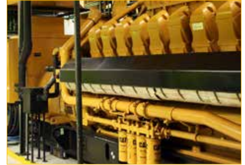
Cuatro grupos electrogenos Cat® G3520C generan energía eléctrica (hasta 8 MW) capaces de satisfacer una carga constante del 100 % para el complejo Rochavera Corporate Towers.
