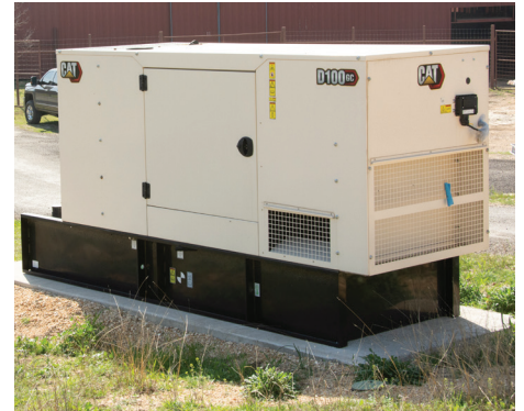
Un nuevo grupo electrógeno Cat GC D100 suministra energía en emergencia a una estación de bombeo en caso de corte de suministro.
