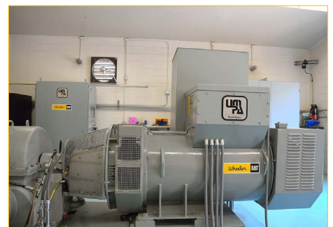
La planta Manti Upper es una de las seis pequeñas plantas hidroeléctricas que opera UMPA y es su planta más grande en función de los kilovatios hora generados.
