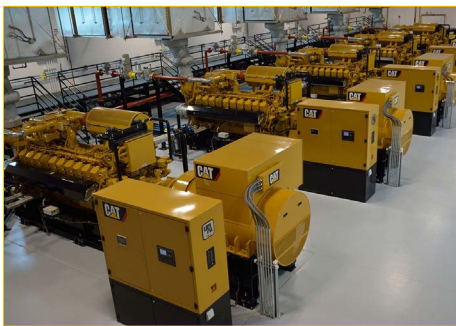
Cinco grupos electrógenos Cat® G3520H alimentan una planta de última generación.
