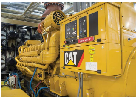
Los grupos electrógenos Car® ofrecen potencia de respaldo confiable para el sistema sanitario de Raleigh, Carolina del Norte.
