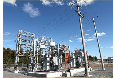
Ubicada a 40 millas al norte de Montreal, la planta de cogeneración Saint-Thomas de EBI Énergie suministra electricidad derivada del biogás de rellenos sanitarios a Hydro-Québec.
