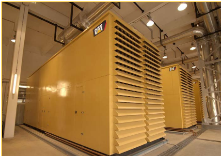
6 Grupos Electrógenos Diésel Cat® C175-16.
