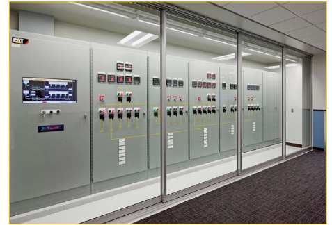
Scott Data Center en Omaha, Nebraska.
