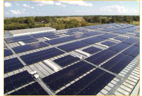
1.550 Paneles Solares Fotovoltaicos Cat® PVT115.
