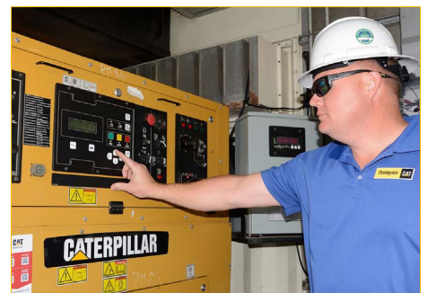
Grupos electrógenos alimentados por diésel y gas de 20 a 2.000 kW.
