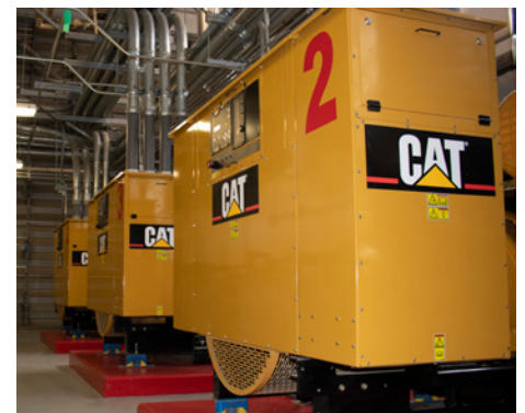
Tres grupos electrógenos C32 de Cat ayudaron al Centro médico OSF St. Francis en Peoria a mantener la energía durante un apagón de emergencia en febrero de 2022.
