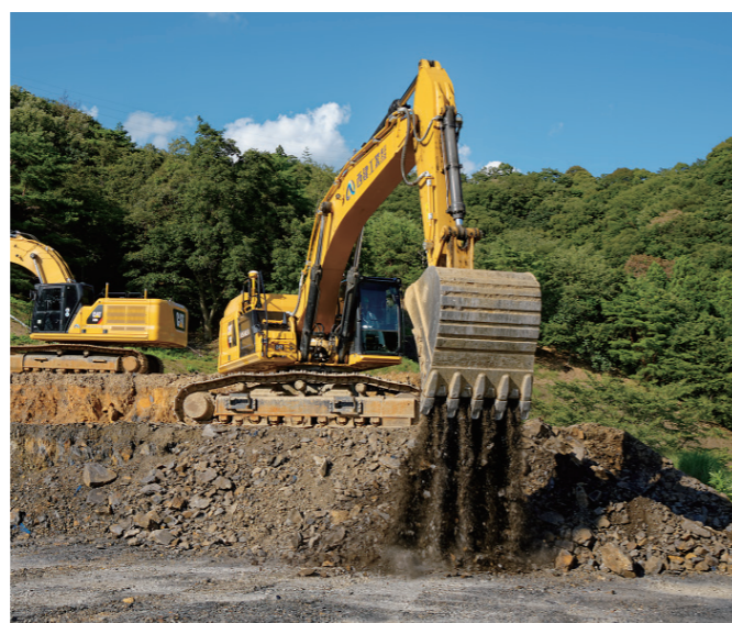
盛土用の土砂を掘削する325と336。 6台のマシンを谷畑様と中丸様の2人で乗り分けて作業をこなされていました。
