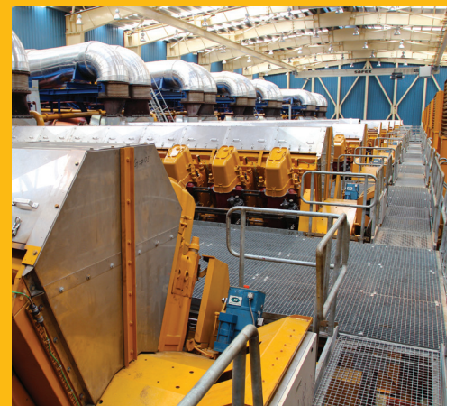
随着安装这8台Cat® 16CM43发电机组, Jhulda的本地发电量大幅增加。
