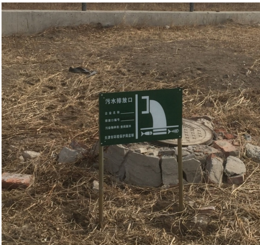
图 4-4 4#门岗污水排放口及标示牌
