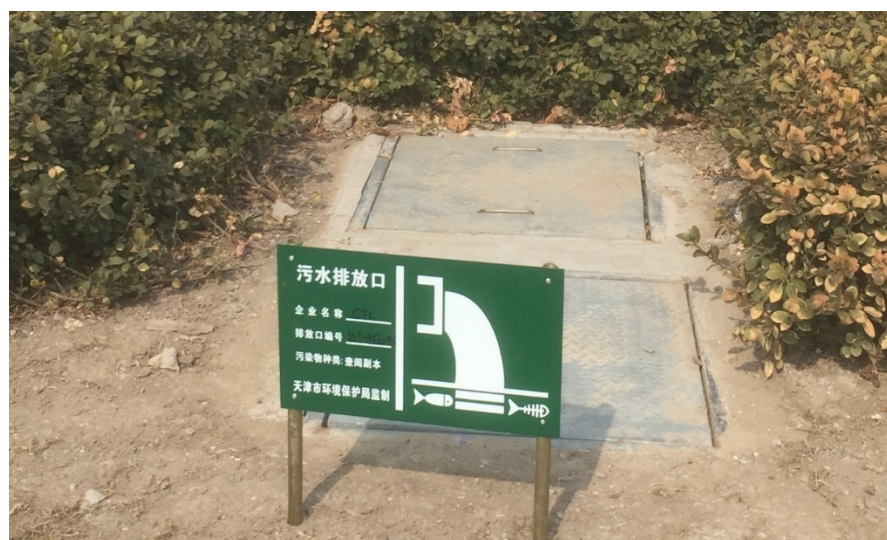
图 4-3 2#门岗污水排放口及标示牌
