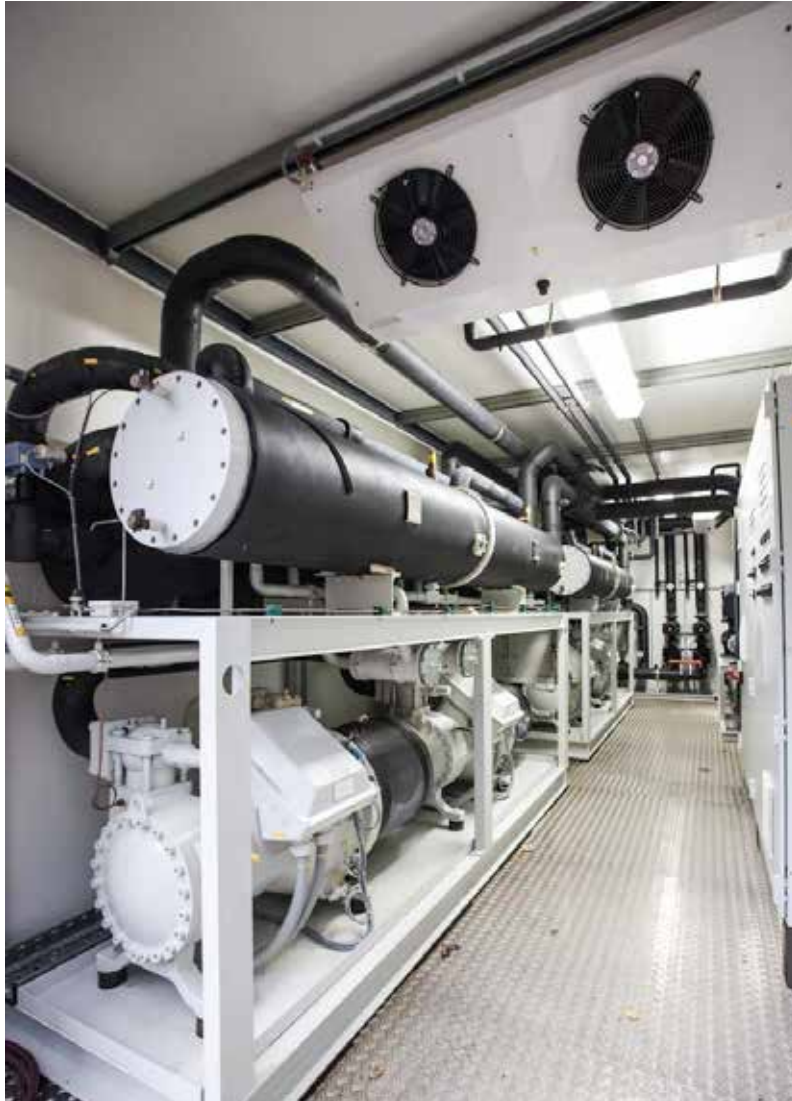
Imagem 3: Bombas de calor industriais instaladas ao lado de um grupo gerador a gás G3520C em uma usina de energia distrital em Reutlingen, Alemanha
