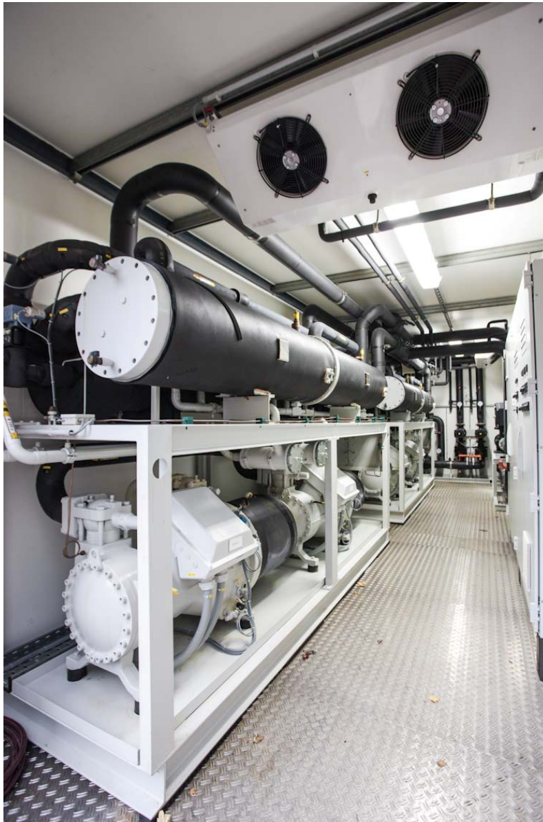
Fotografía 3: Bombas de calefacción industriales instaladas junto con un Grupo Electrónico de gas G3520C ubicadas en una planta de energía en Reutlingen, Alemania.
