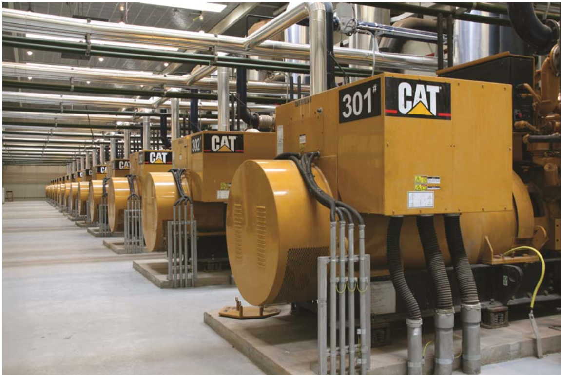
Fotografía 2: Interior de una de las cuatro plantas de energía de gas de carbón que emplean generadores de vapor con recuperación térmica de escape para alimentar una turbina de vapor de 3 MW.
