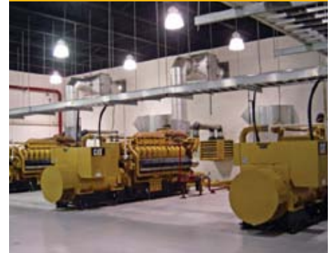
Tres Grupos Electrógenos Caterpillar G3520C de alto voltaje a 2.050 kW.
