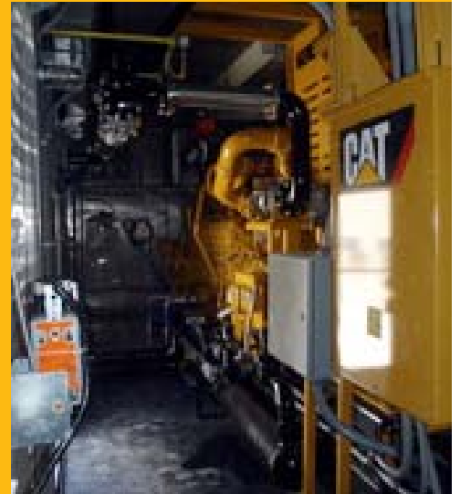
图注：自2011年8月安装以来，卡特彼勒G3516机组平均以98% - 99%的产能运转已超过3000小时，短时间的停机是因为公共电网断电
