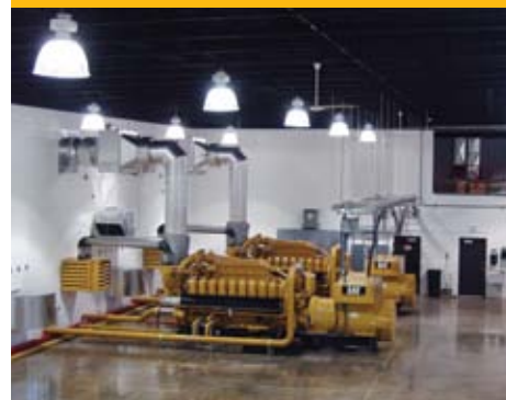
发电厂建设一期工程。 两台卡特彼勒G3520C 高压发电机组 每台功率均为 2050 ekW。
