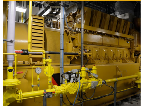
Cat® CG260-12 天然气发电机组，安装在万锦市区域能源的 Birchmount 能源中心，用于热电联产 (CHP) 应用。
