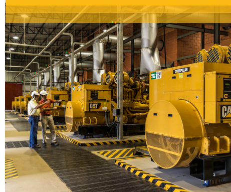
34 grupos geradores diesel Cat® C175-20 fornecem 3.150 kW de potência bruta para a capital de Boa Vista.
