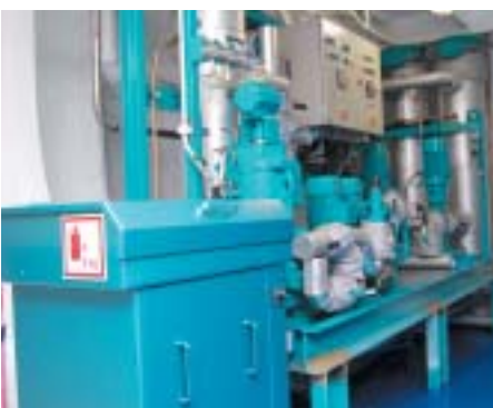
Eftefing Engineering supplied the HFO booster module
