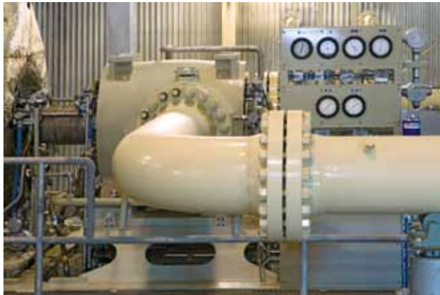
Compresor de gas C33
