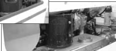
Система мокрой очистки выхлопных газов
