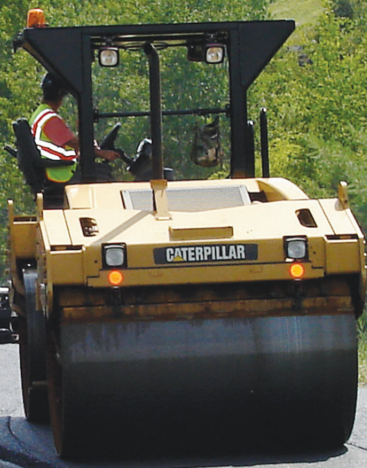
▲ Compacteur Cat® d'une largeur de 2 mètres travaillant dans la zone la plus chaude, à quelques mètres du finisseur
