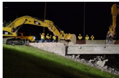
A reforma da estrada de Dallas-Fort Worth representa bem a necessidade das melhorias necessárias na infraestrutura no mundo desenvolvido.
